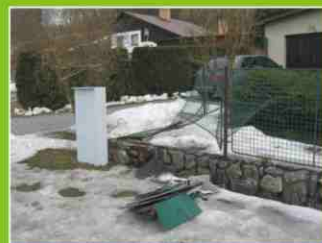
Nová zesilovací stanice KTV po dopravní nehodě.
