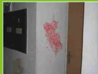
Vandalismus ve školní jídelně.
